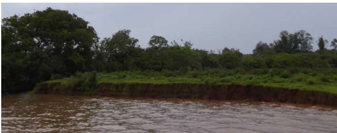
Figura 3.14 - Processo erosivo na margem esquerda do rio Taquari-Antas.
