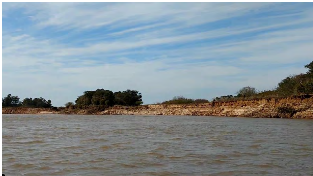
Figura 5.26 – Margem direita, margem côncava e erosiva, com processo erosivo (Ponto 168).
