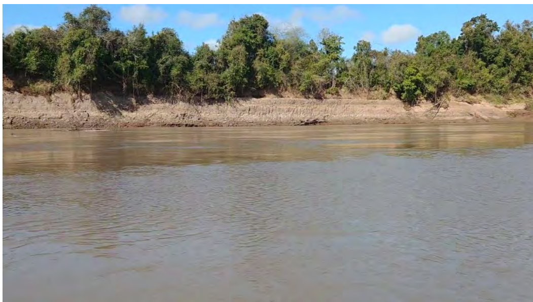
Figura 5.16 – Ponto 84 na margem direita (margem deposicional) onde se observa processo erosivo, mas com vegetação na porção superior, mas não no talude.
