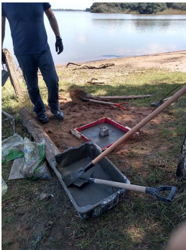
Figura 4.7 – Detalhe da instalação do Marco 09 na Praia da Cachoeirinha, no Rio Jacuí ao lado da RS 401.
