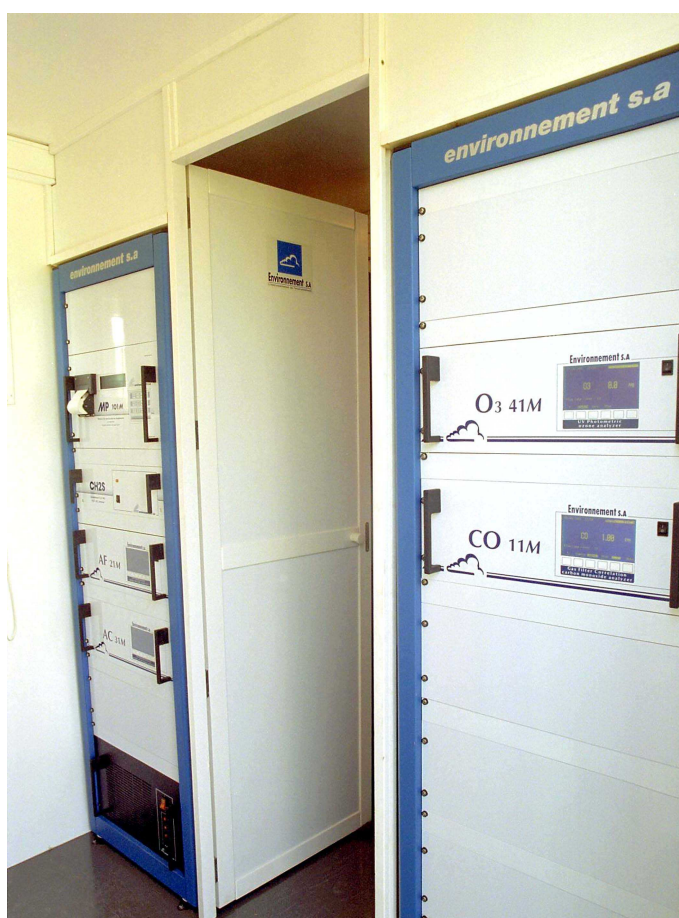
Figura 13: Rack dos analisadores.
